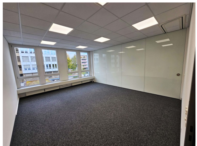
Büro oder Sitzungszimmer mit mobiler Glastrennwand
